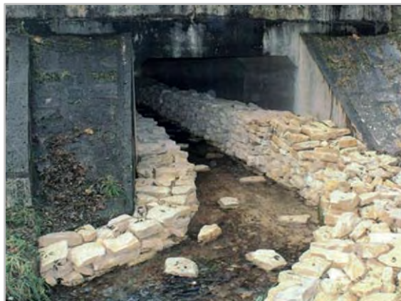
Photo 28C : Aménagement d'une banquette en matériaux naturels (ici scellés) dans l'ouvrage de franchissement de ruisseau, © CEREMA, 2021, Conseil Départemental de Dordogne
